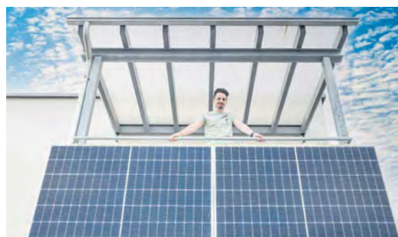
▲ Kein aber oho. Mit zwei Modulen auf dem Balkon erzeugt Moser rund ein Drittel seines Strombedarfs.
